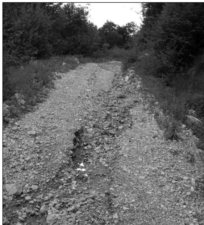
Abb. 1: Erodierter, aber noch nutzbarer Forstweg in Montenegro (Foto: W. GUGLHÖR)
